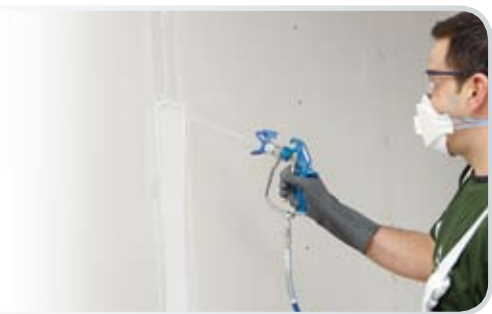
Realizar un tratamiento Q2 en las juntas Efetuar um tratamento Q2 nas juntas
